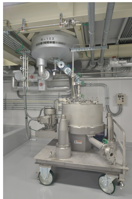
プラント内部 3
