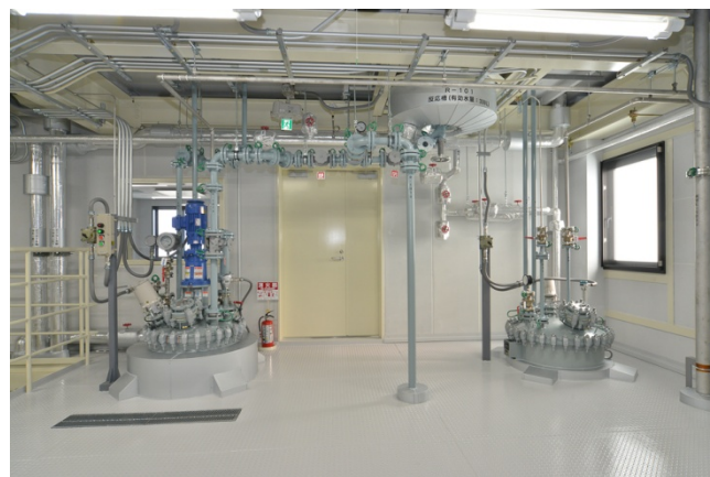
プラント内部 1
