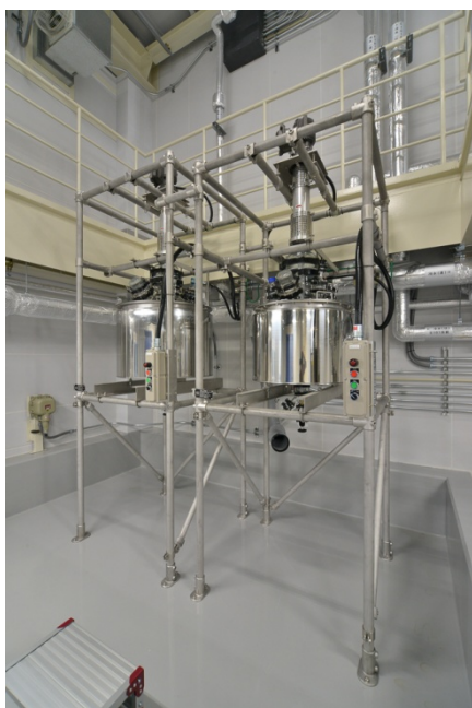
プラント内部 2
